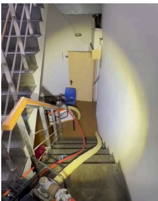
Evacuació d'aigua de la Casa de la Mina de Montcada i Reixac.
